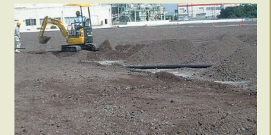
▲下水処理場覆蓋緑化工事で施工された排水材。カルグリを排水材として使用しています。
